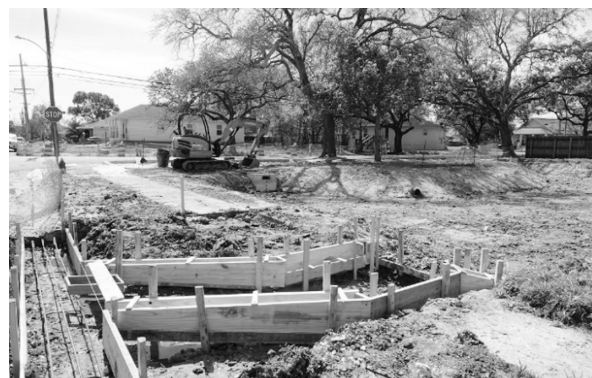
写真3 米国ハリケーン・カトリーナの被災地ニューオーリンズ市で進む災害空地を活用した雨水貯留工事（2020年3月、著者撮影）
